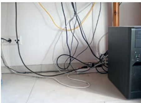
Ein Kabelsalat unter dem Schreibtisch ist immer schlecht: Bleibt man mit dem Fuß oder Stuhl hängen, ist ein Sturz absehbar. Reißt man am Kabel, gehen die Anschlüsse kaputt. Der Staub zwischen den Kabeln lässt sich nur schwer wegputzen.
